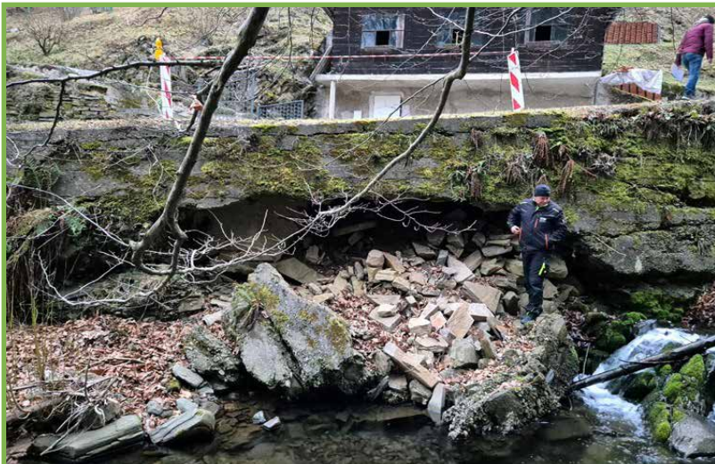
Abbildung 29: Starke Regenfälle haben die Straße beschädigt und auch das Haus ist stark gefährdet.
