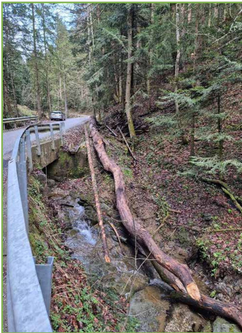
Figure 29 : Une mauvaise gestion forestière et des résidus dans les cours d'eau sont un véritable fléau pour la route.
