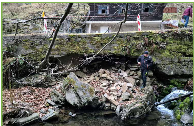
Figure 28 : Les fortes pluies ont endommagé la route et la maison est également menacée.
