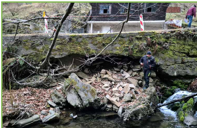
Figura 28: Le forti piogge hanno causato danni alla strada e anche la casa è a rischio.
