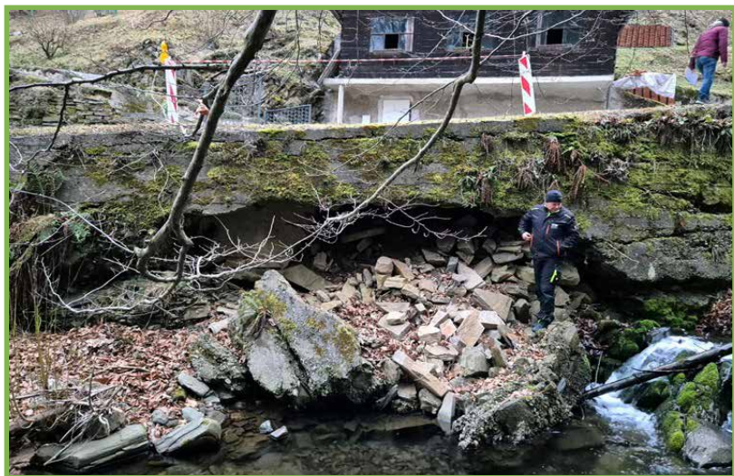
Slika 28: Močno deževje je povzročilo škodo na cesti, hiša pa je prav tako zelo ogrožena.
