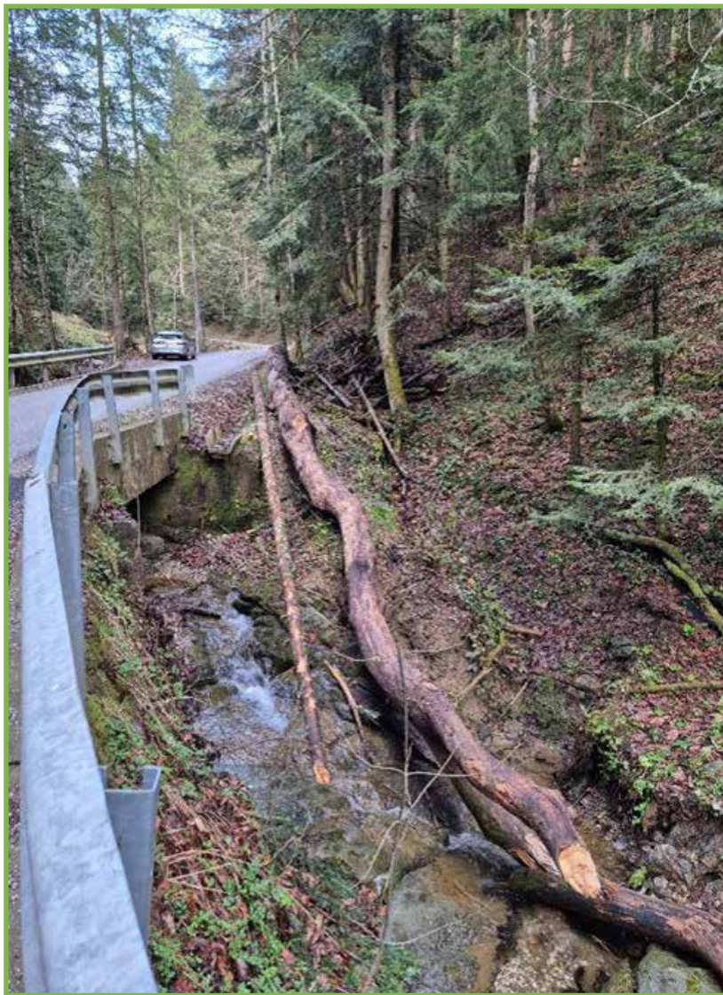
Slika 29: Napačno gospodarjenje z gozdovi in ostanki v potokih so največja nevarnost za cesto, ker začasno zajeziijo vodo, ki nato povzroči poplave
